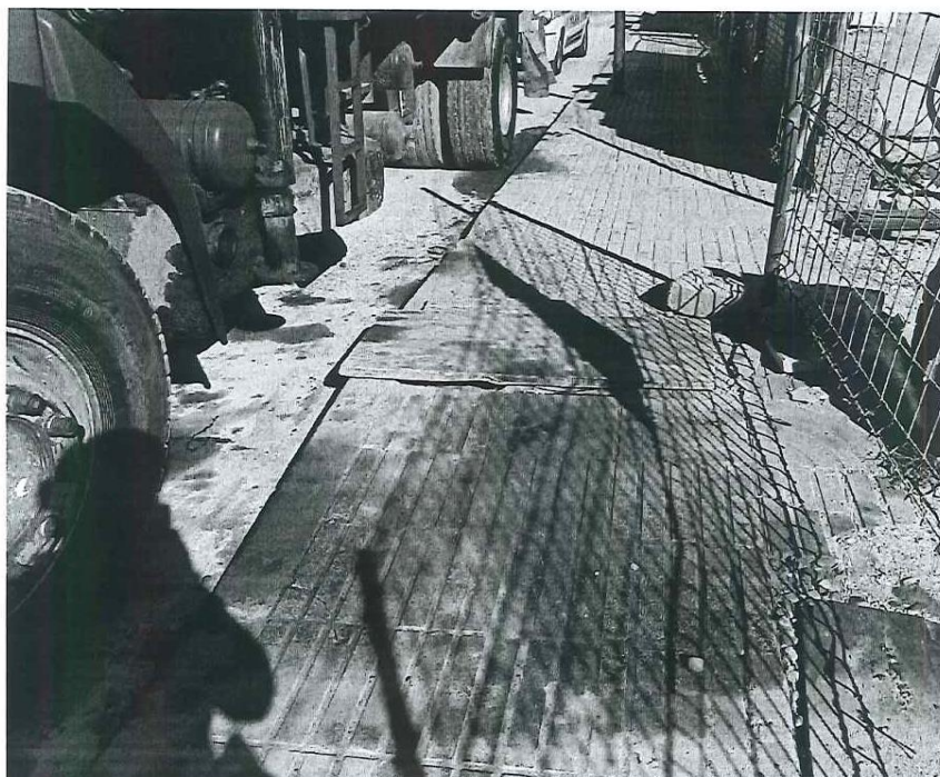
FOTO Nº 3: Detalle de las manchas de aceite sobre la acera.
