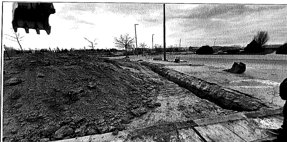
FOTO Nº 3: Detalle de la acometida.
