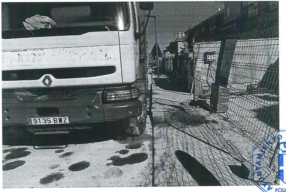
FOTO Nº 2: Detalle de las manchas de aceite procedentes del camion.
