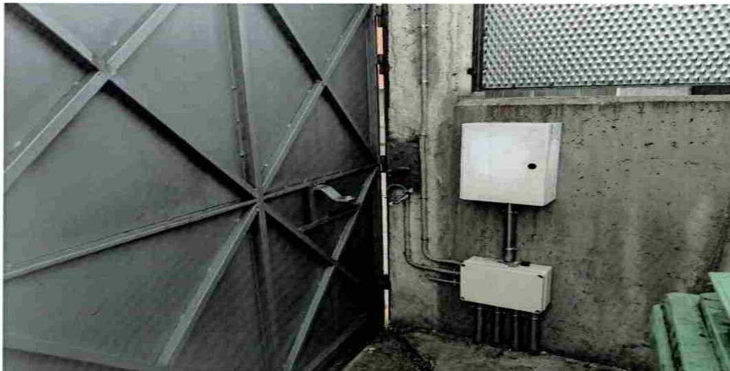
Puerta del garaje derecha donde se puede apreciar que no tiene el brazo hidráulico.
