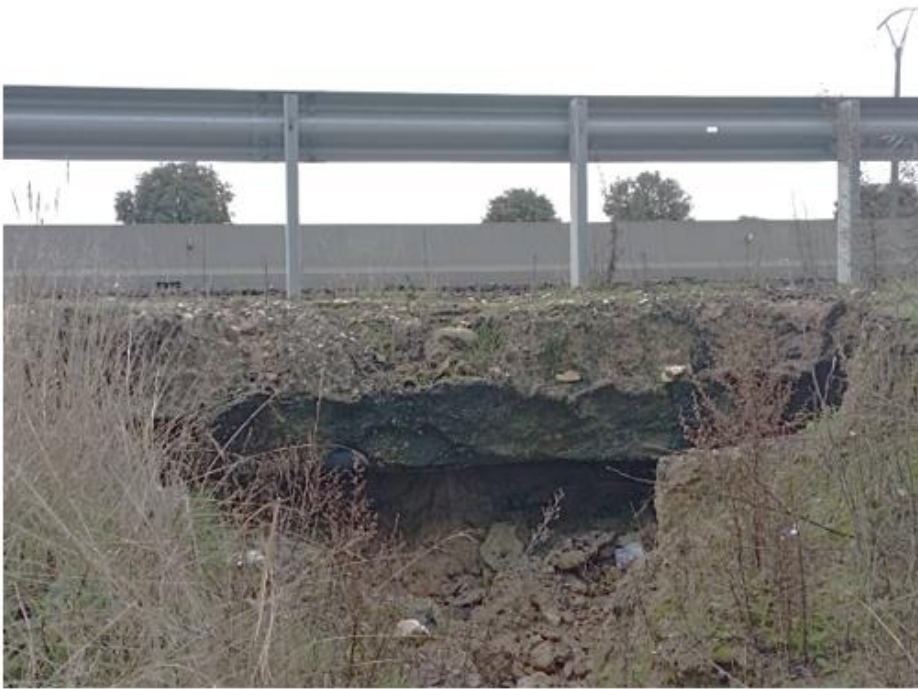
Estado de alguna de las cárcavas con socavado
